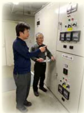
機械室で設備管理を行う 高橋さんと白石さん
