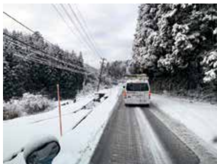
地震で崩落した道路（左側車線）。前の車両は福山市民病院チーム
