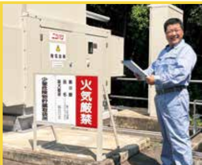
更新した非常用発電機と森原さん
